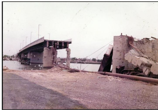
تخریب پل خرمشهر در دوران جنگ تحمیلی
