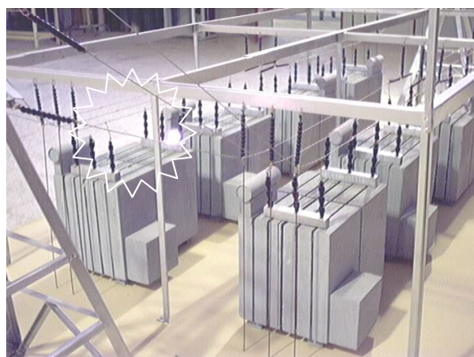
شکل ۷- قوس الکتریکی ناشی از اتصال کوتاه در خطوط برق ولتاژ بالا بعلت تماس الیاف گرافیت.
